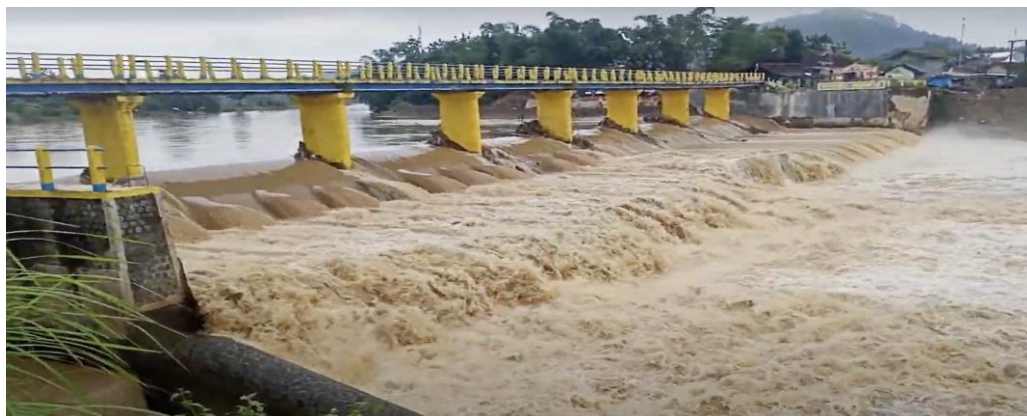
Gambar 12 Pola aliran pada Bendung Cikeusik pada saat banjir tahun 2020 (sumber : BBWS Cimanuk Cisanggarung, 2020)
