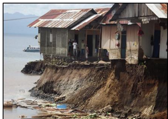
Gambar 9 Kondisi bibir pantai yang tererosi pasca banjir lahar 2012 sebelum pembangunan kanalisasi
