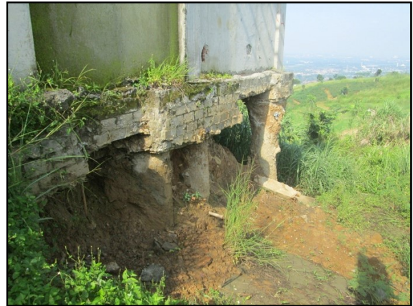
Gambar 11 Longsor di pondasi tribun stadion bola.
