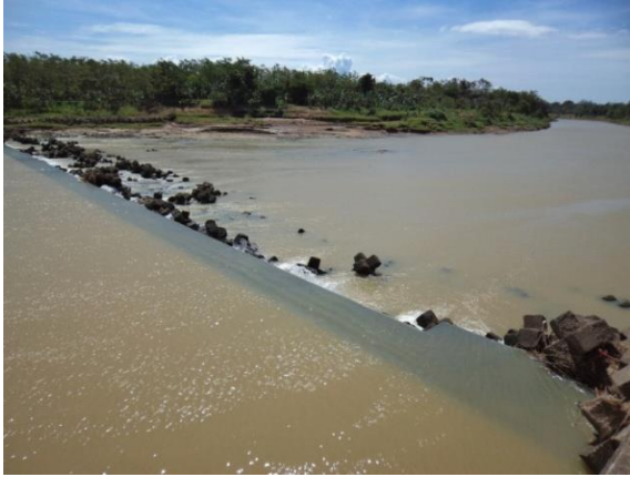
Gambar 1 Kondisi BBT di hilir Bendung Gerak Pamarayan Baru
