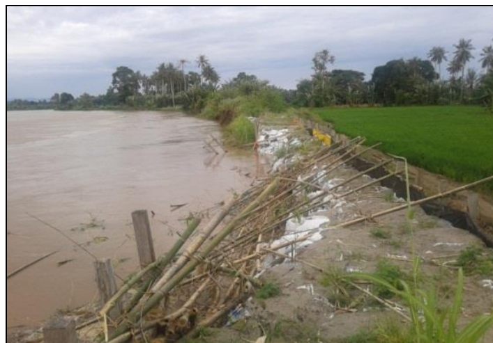
Gambar 11 Lokasi Tikungan Luar Sungai Saddang (Bakoko) Yang Telah Mengalami Gerusan
