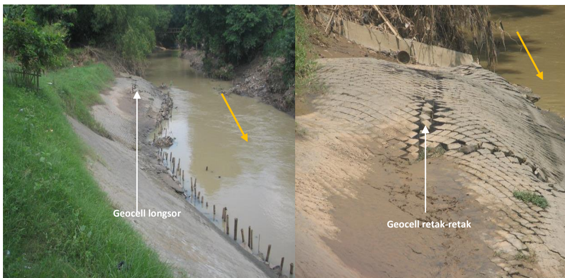
Gambar 1 Kerusakan pelindung tebing sungai dengan geocell
